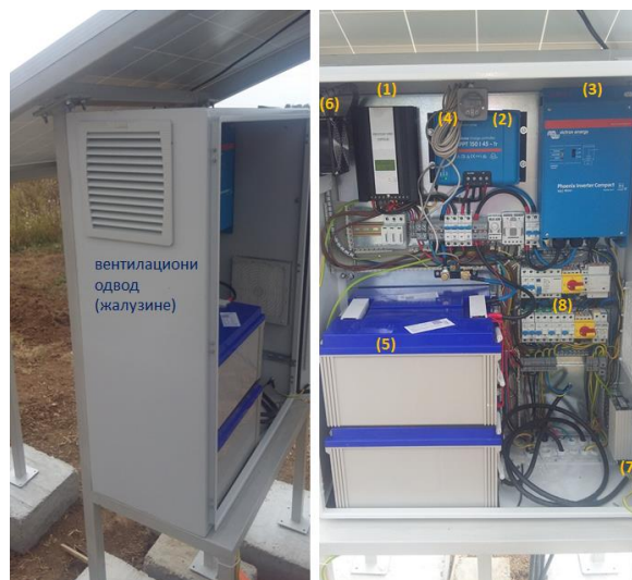
Слика 15. Приказ спољашње монтаже ГРО и распоред опреме унутар ГРО
